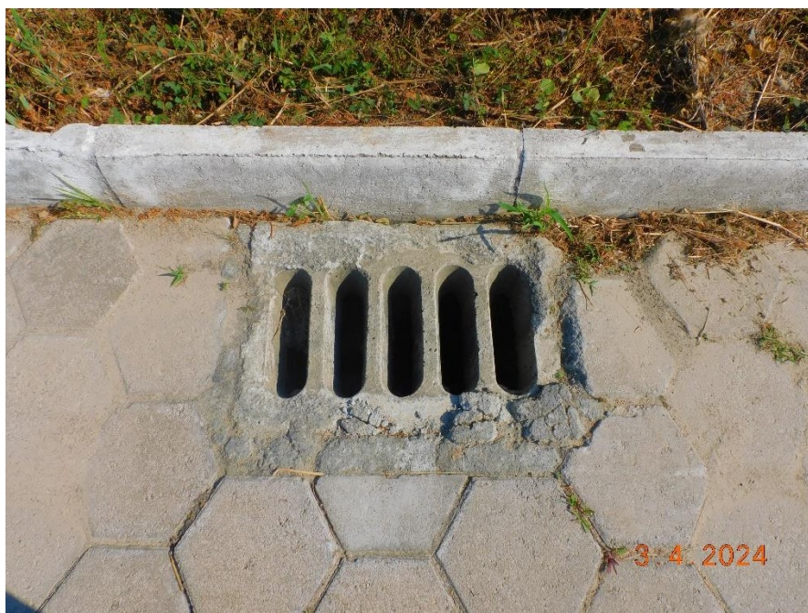
Figura 36- Sistema de drenagem presente no futuro empreendimento. Fonte: RIBAS Consultoria Ambiental, 2024.
