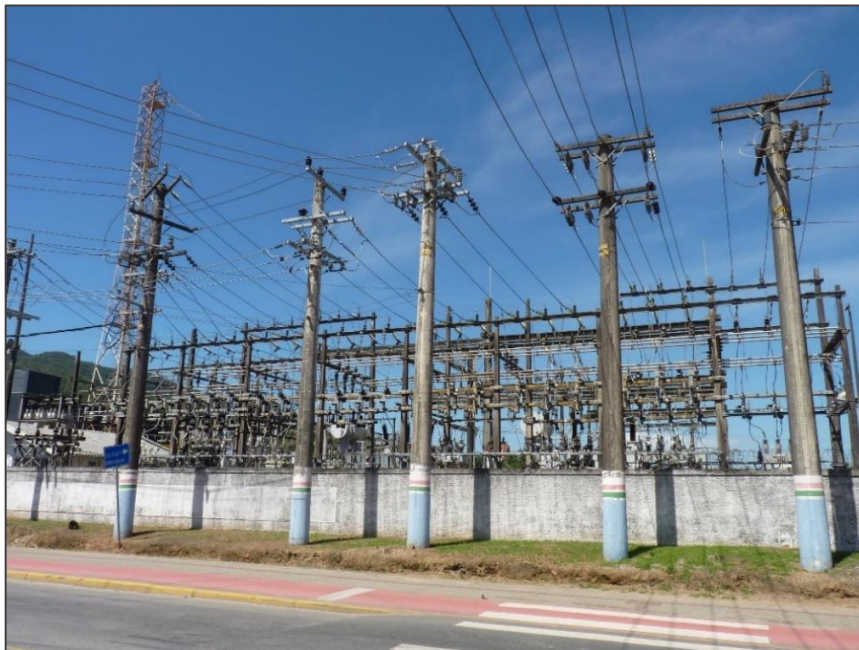
Figura 21 -Subestação de distribuição de energia da CELESC na área de influência do empreendimento.
