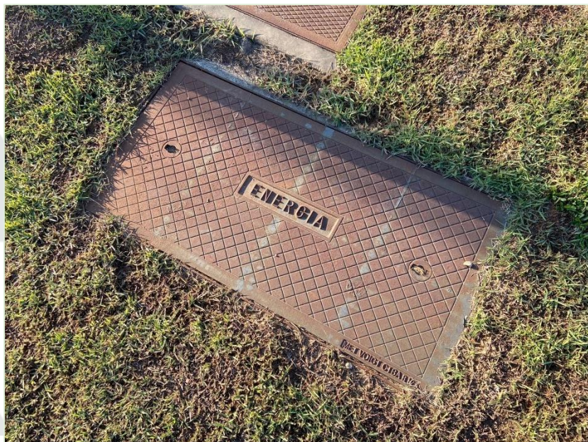
Figura 70 - Rede de energia elétrica.
