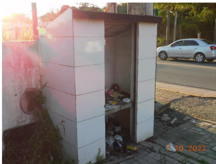
Figura 32- Armazenamento de resíduos sólidos para coleta pública no imóvel. Fonte: RIBAS Consultoria Ambiental, 2022.
