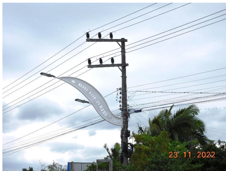
Figura 31- Fornecimento de energia elétrica no entorno do futuro empreendimento. Fonte: RIBAS Consultoria Ambiental, 2022.
