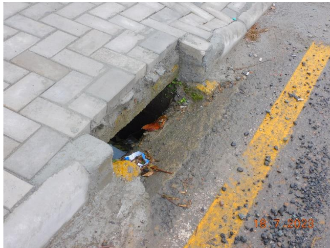
Figura 31- Sistema de drenagem presente no futuro empreendimento. Fonte: RIBAS Consultoria Ambiental, 2024.
