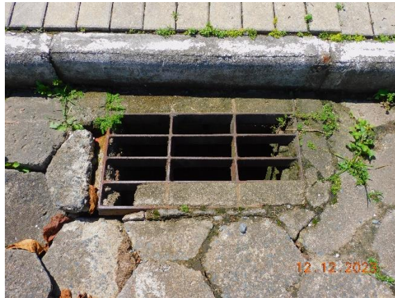
Figura 38- Sistema de drenagem presente no futuro empreendimento. Fonte: RIBAS Consultoria Ambiental, 2024.
