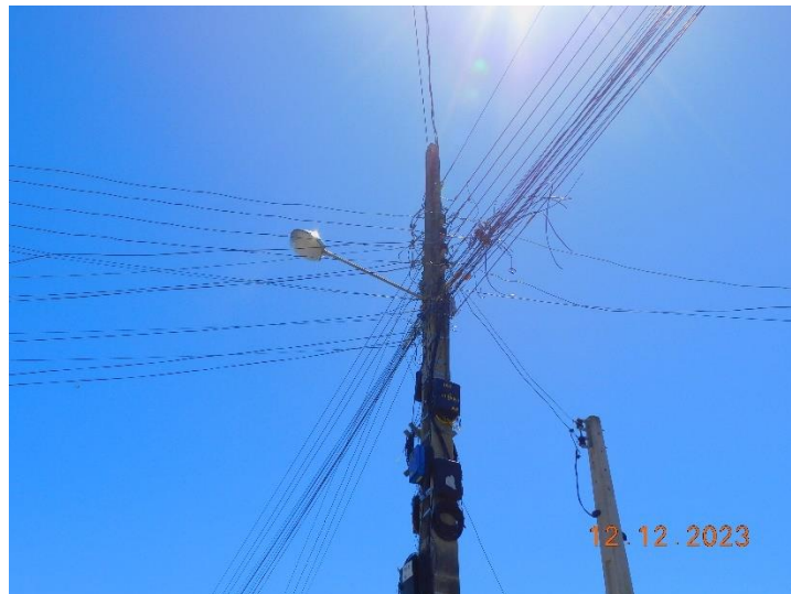
Figura 39- Fornecimento de energia elétrica no entorno do futuro empreendimento. Fonte: RIBAS Consultoria Ambiental, 2023.
