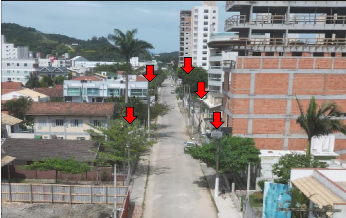
Figura 13. Rede elétrica presente na Rua Blumenau, Porto Belo (SC).
