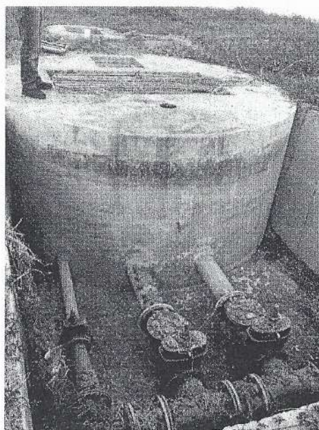
Figura 17 – EE-B04 – Detalhe do barrilete.
