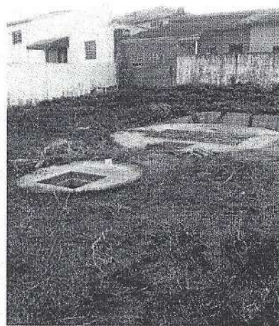
Figura 19 – Vista geral da EE-04.
