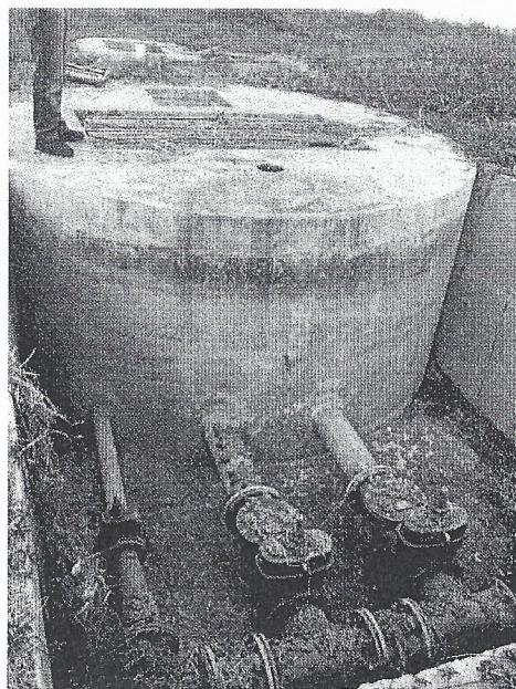
Figura 17 – EE-B04 – Detalhe do barrilete.
