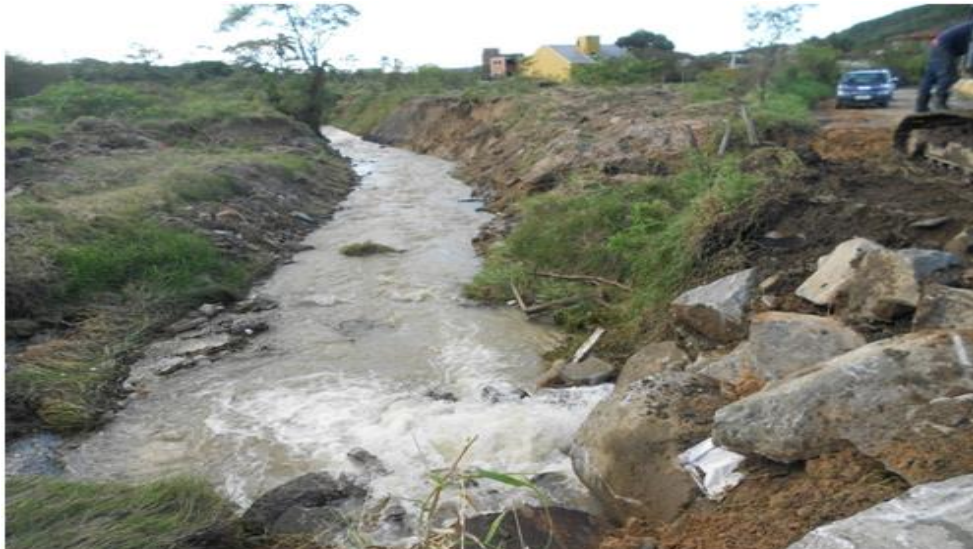
Foto 4 - Execução de Desassoreamento no Rio Perequezinho, Bairro Vila Nova (2017). Fonte: Defesa Civil, 2017.
