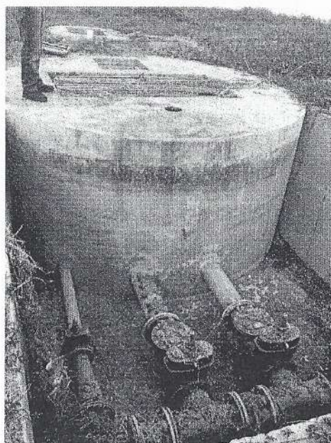
Figura 17 – EE-B04 – Detalhe do barrilete.
